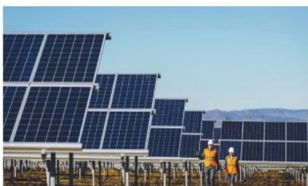
a) Nhà máy điện Mặt Trời
