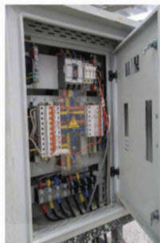
Hình 6.4. Bên trong một tủ điện phân phối
