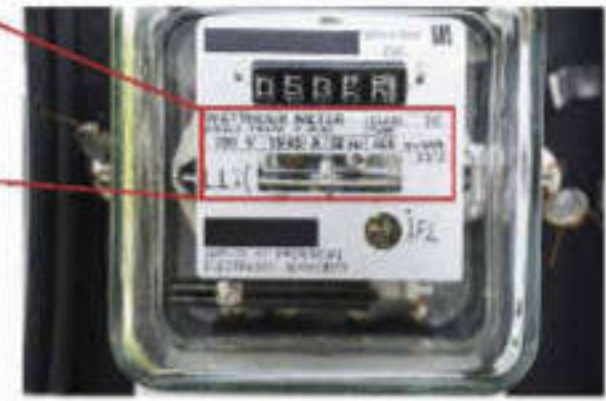
Hình 9.2. Công tơ điện 1 pha
