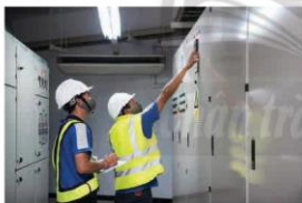
a) Vận hành hệ thống điện
