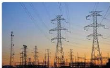
Đường dây điện cao thế.
