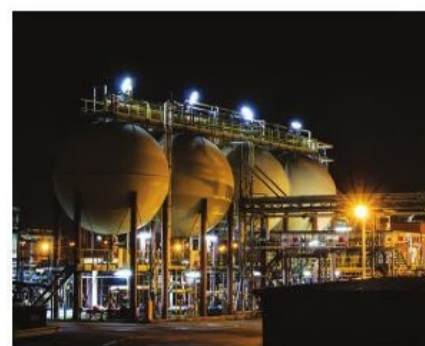
Hình 18.1. Bồn chứa hydrochloric acid ở một nhà máy hoá dầu tại Vương quốc Bỉ
