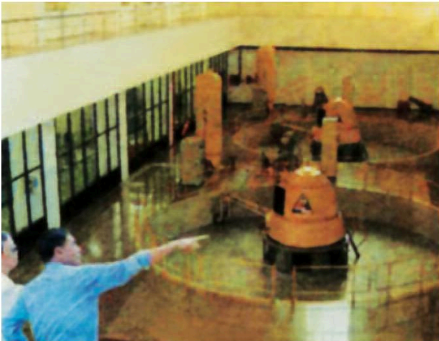
Hình 9.1. Một tổ máy phát điện tại nhà máy thủy điện Sê San 3A
