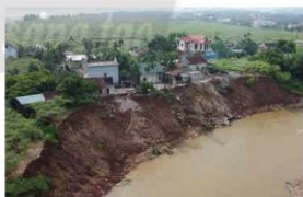
Sạt lở ở xã Tư Vũ, huyện Thanh Thủy, tỉnh Phú Thọ (Ảnh: Tạ Toàn/TTXVN)
