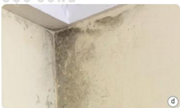
Nấm mốc ở góc tường nhà.
