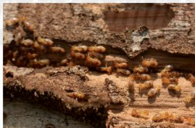
Mối phá hoại công trình xây dựng
